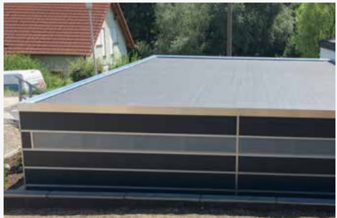
Dach aus EPDM-Membrane
