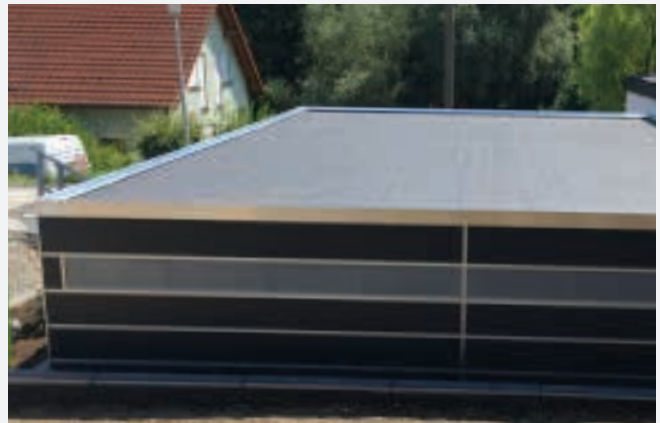
Dach aus EPDM-Membrane
